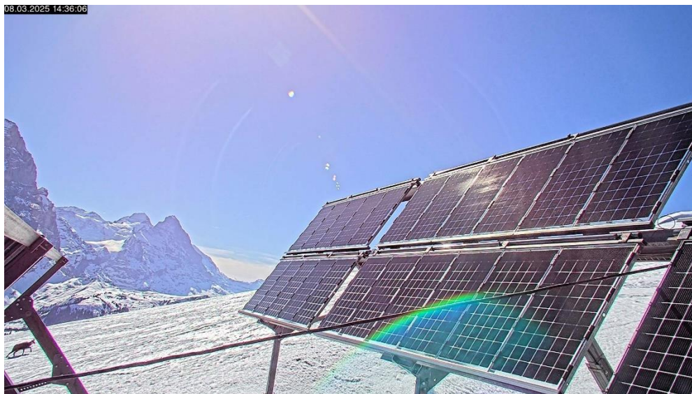
L'installation-pilote de Tschingel photographiée le 8 mars 2025 par une caméra installée sur place.
